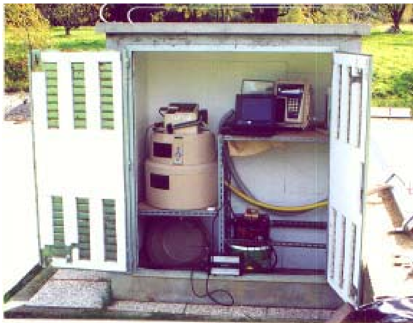
Fig. 1 Stazione di monitoraggio con l'idrometro ad ultrasuoni, a destra, il campionatore automatico di liquidi, a sinistra, ed il PC portatile per scaricare i dati; sul muretto è posto il sistema di sostegno della sonda ad ultrasuoni, di cui si vede la protezione.
